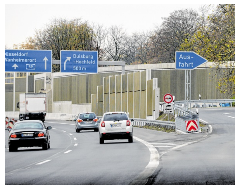
Weil sich der offeneporige Asphalt schon löst, gilt auf der A59 stellenweise nur noch höchstens Tempo 60. FOTO: STEPHAN EICKERSHOFF
